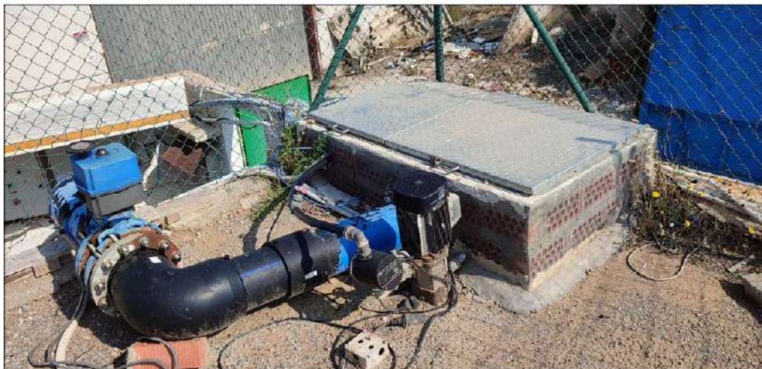
Imagen 5. Tubería de entrada a depósito sobre cubierta (fachada trasera).
