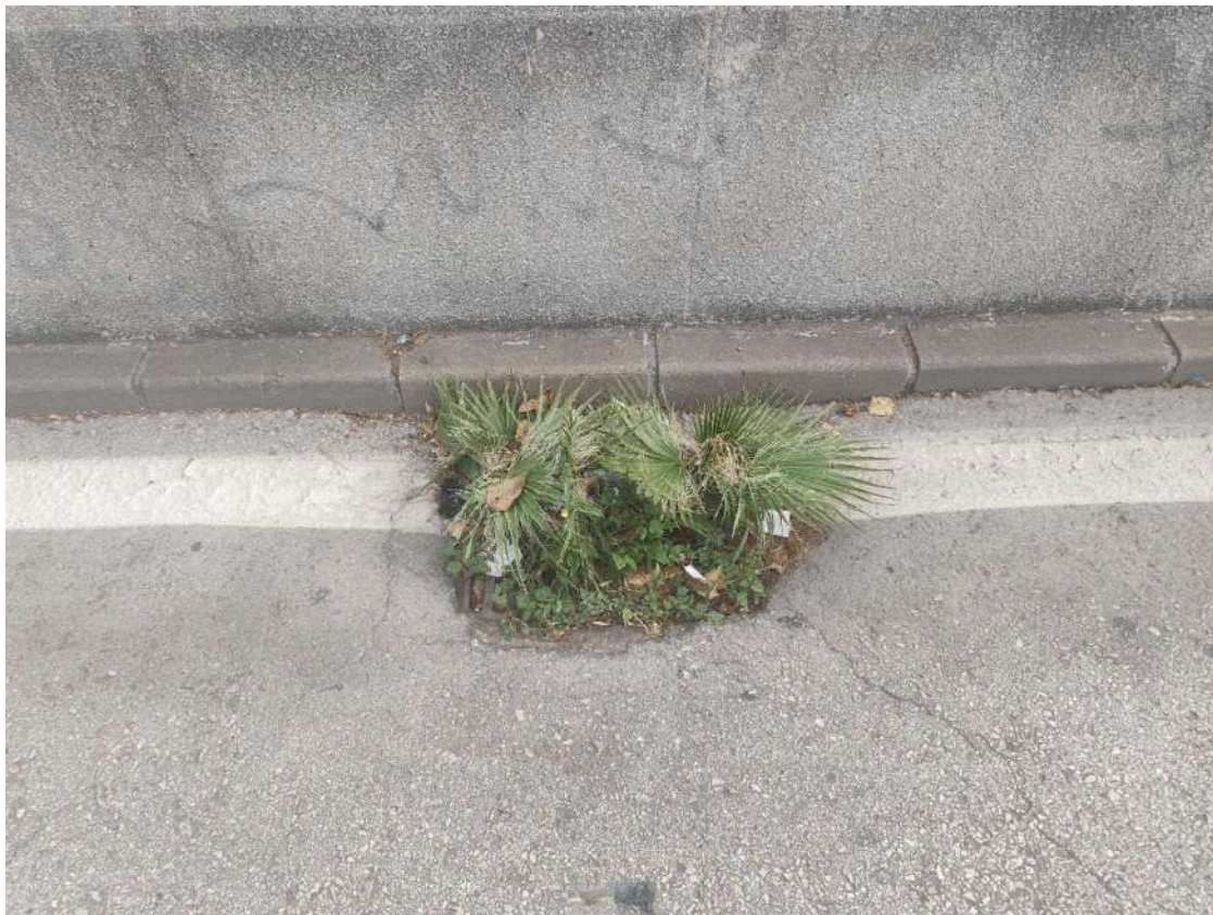
Un imbornal completamente cubierto por la maleza frente a la sede de Emalgesa.
