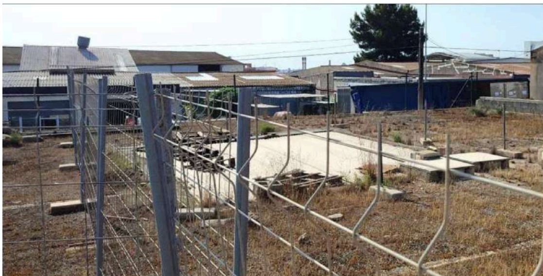
Imagen 3. Panel de cobertura existente en hueco colapsado.
