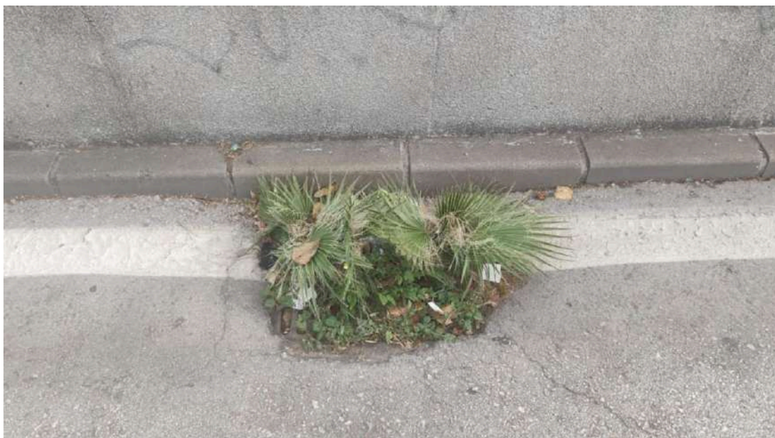
Imbornales obstruidos en Algeciras / IU
